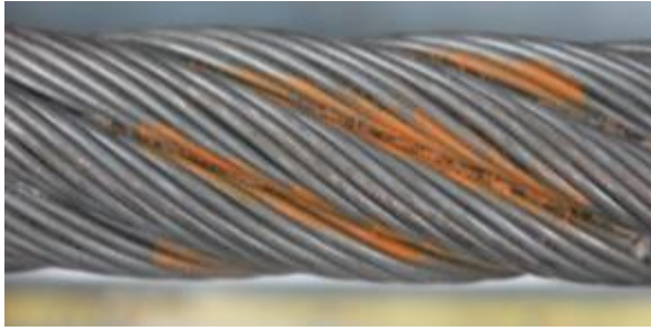
Abbildung 6.21: Korrosion in Litzen-gasse
