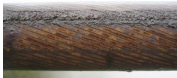
Abbildung 6.18: Korrosion bei einem vollverschlossenen Seil
