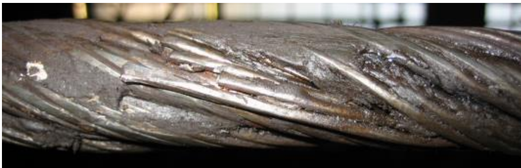
Abbildung 8.13: Verschmutztes Seil – Inspektion nicht möglich
