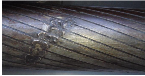
Abbildung 4.15: Einschlag-/Austrittsstelle an der Seite des Seils
