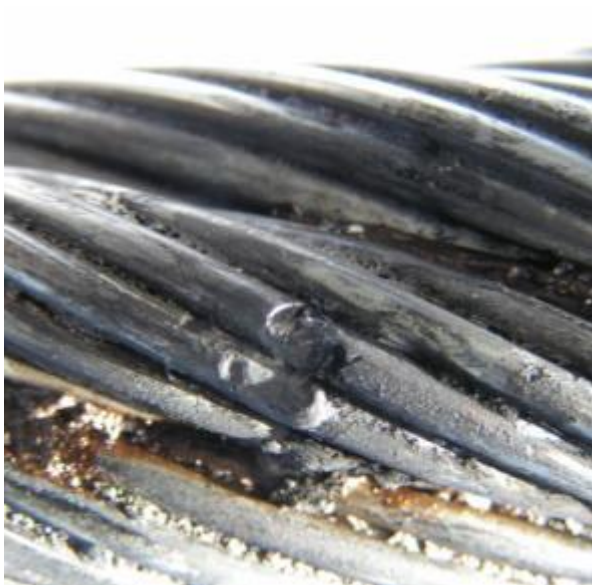
Abbildung 4.4: Schaden durch Stromfluss
