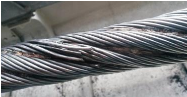
Abbildung 4.3: Eingefallene Stoßstelle mit einigen Drahtbrüchen
