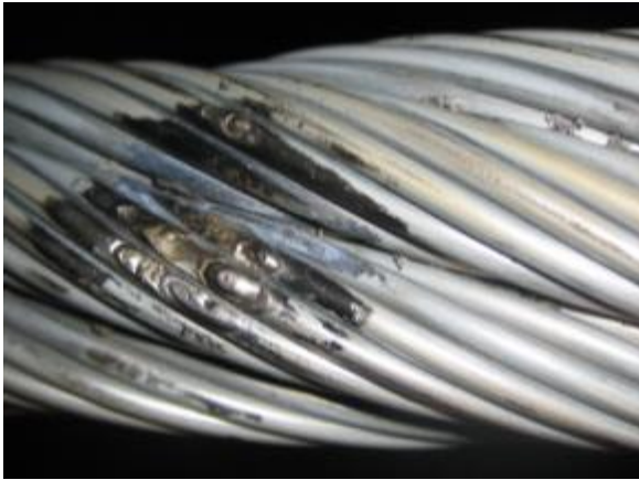
Abbildung 4.10: Blitzschaden an Litzenseil
