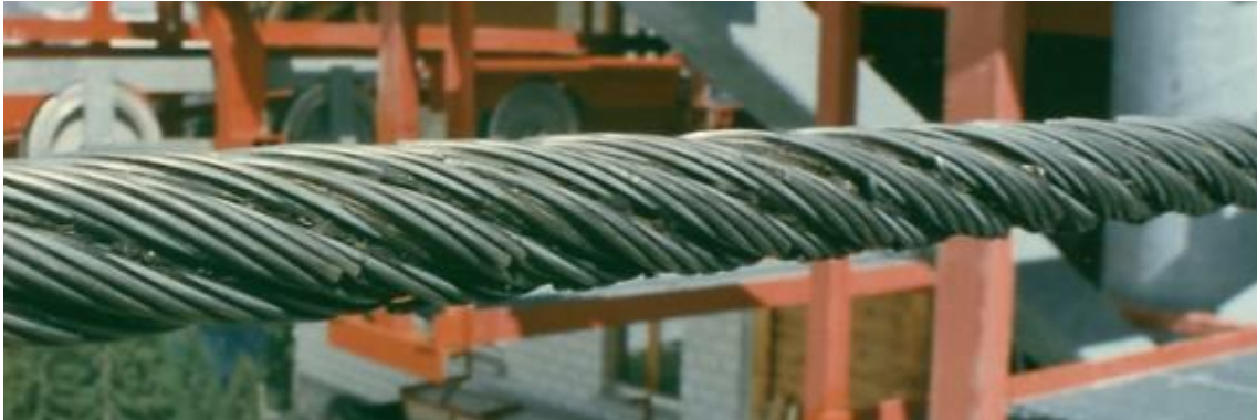
Abbildung 4.1: Schäden von gerutschter Klemmplatte
