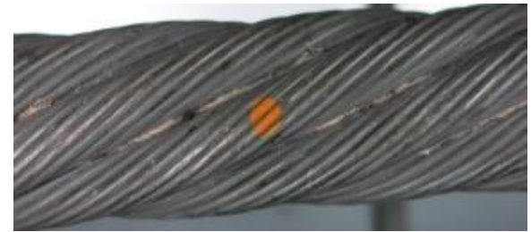
Abbildung 6.24: Korrosion 0,5 x Litzen-durchmesser
