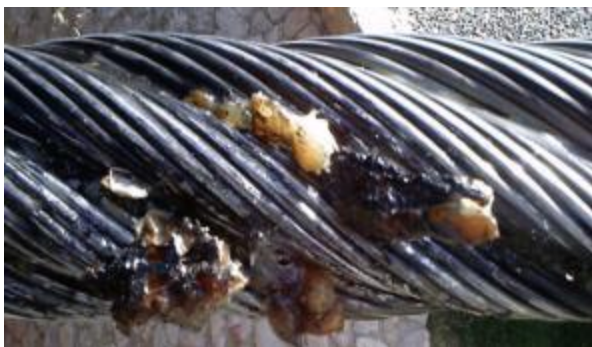
Abbildung 4.12: Blitzschaden mit großer Beschädigung an Litzenseil
